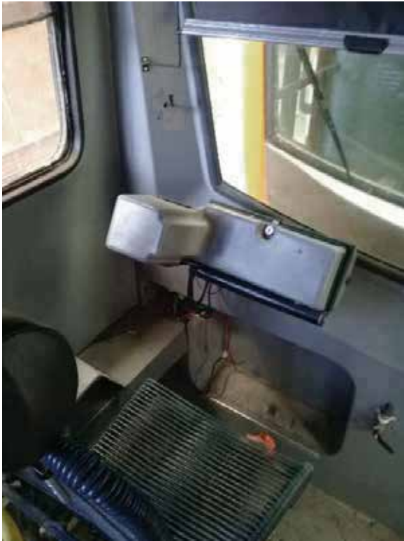
Foto 5: Interior – comando cerrado
