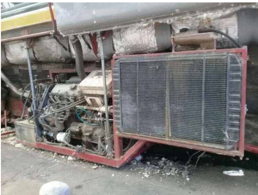
Foto 8: Interior – motor duna
