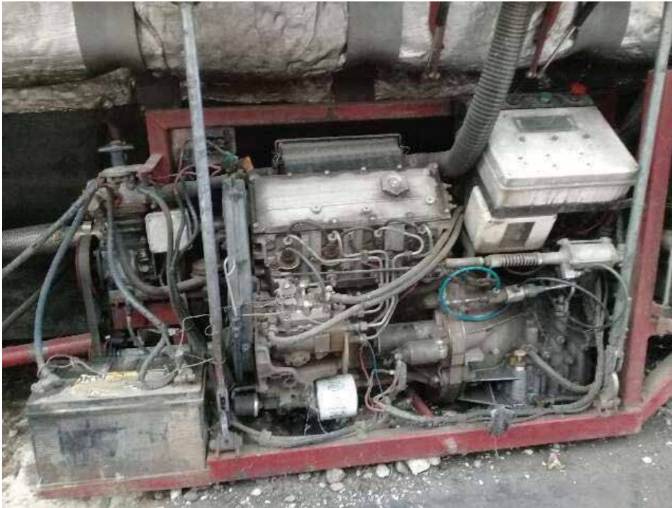
Foto 9: Interior – motor duna
