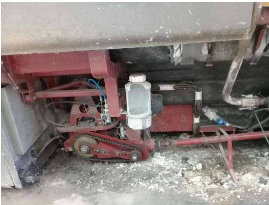
Foto 12: Exterior – recipiente roto
